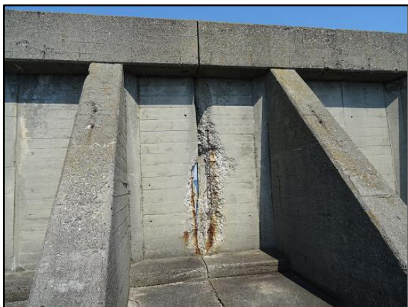
整備前 （既設老朽化状況）
