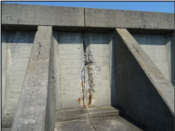
整備前 （既設老朽化状況）
