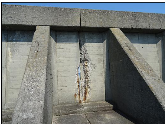
整備前 （既設老朽化状況）
