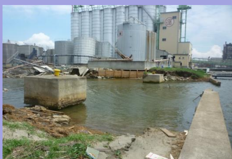
地盤沈下や護岸損壊による浸水の被害が甚大なサイロ(石巻港)
