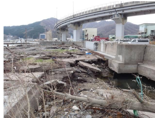
海側が洗掘 (写真:釜石港海岸須賀地区)
