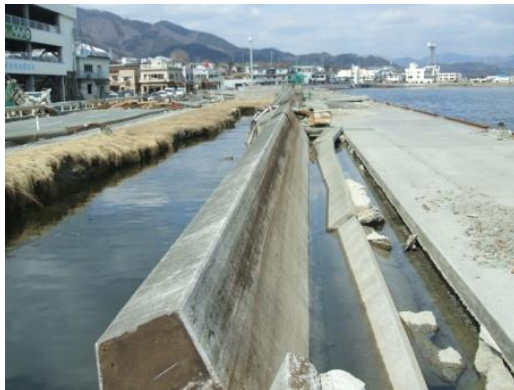
堤体が陸側に倒壊 (写真:大船渡港海岸茶屋前地区)
