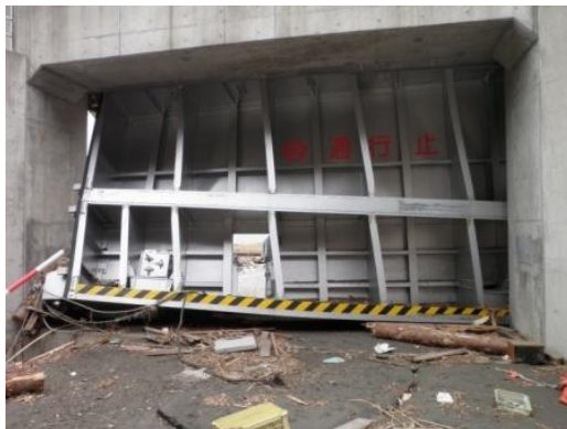
陸閘が陸側に破損 (写真:宮古港海岸高浜地区)
