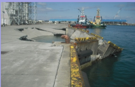
損壊して利用不能となった岸壁 (相馬港)
