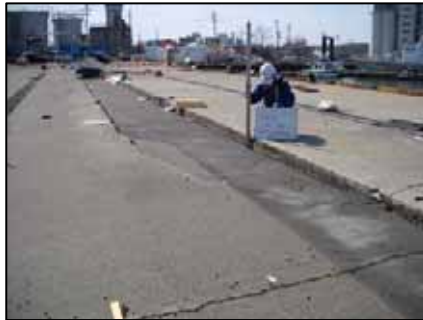
中ふ頭の背後アスファルト舗装沈下
