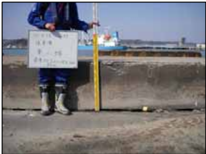
東ふ頭の背後アスファルト舗装が広範囲にわたり沈下
