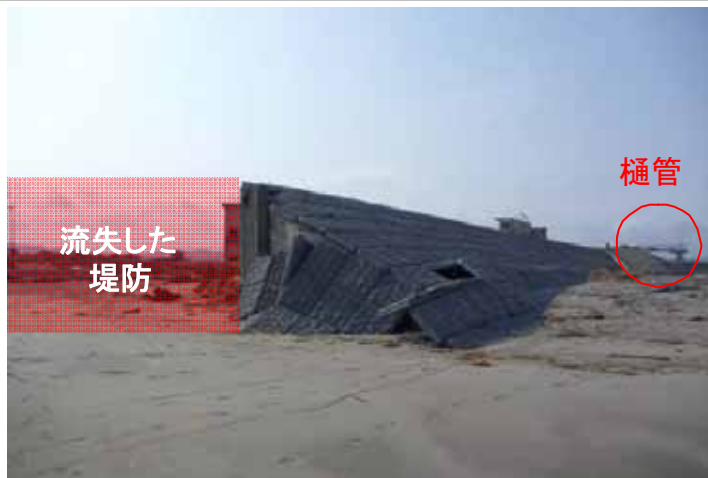
阿武隈川の堤防の一部が流出(宮城県岩沼市)
