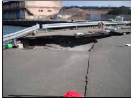
東ふ頭のアスファルト舗装が被災
