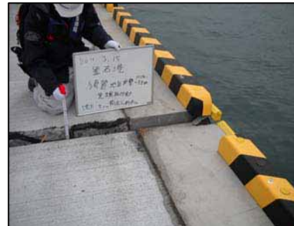
須賀地区岸壁-7.5m先端取付部沈下、前出し
