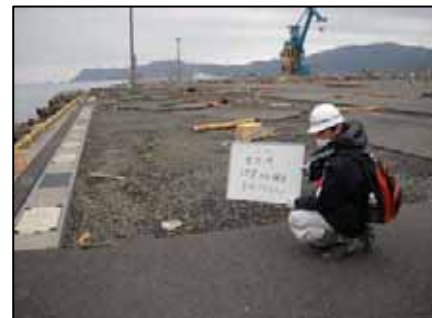
須賀地区護岸背後アスファルトが広範囲にわたり被災
