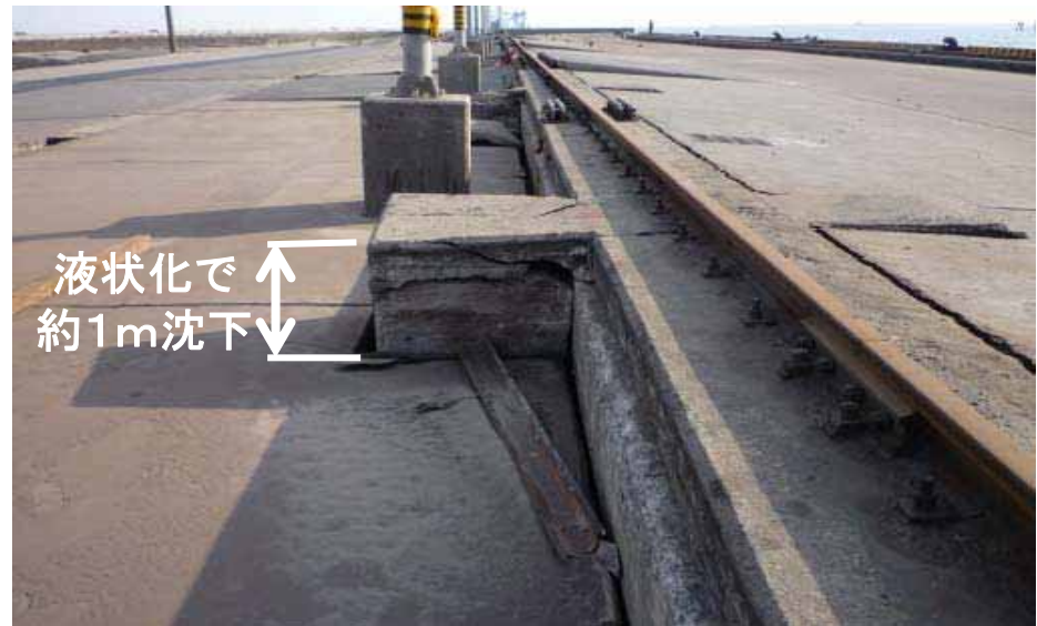
小名浜港 3号ふ頭 岸壁の液状化で荷役機器レール付近の沈下
