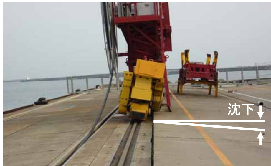
小名浜港 大剣ふ頭地区 2・3号岸壁(-10m)の荷役機械の損壊
