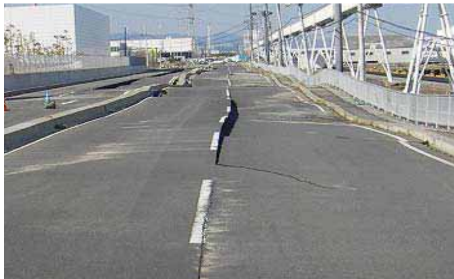
茨城港 常陸那珂港区 臨港道路5号線 液状化による損壊
