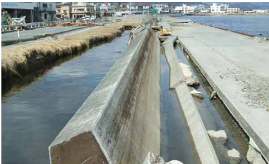
大船渡港 茶屋前地区 防潮堤の倒壊
