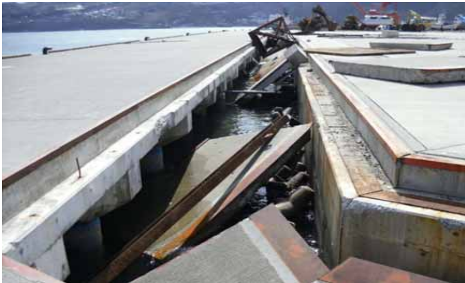
久慈港 諏訪下地区 岸壁の損壊(渡版の落下)
