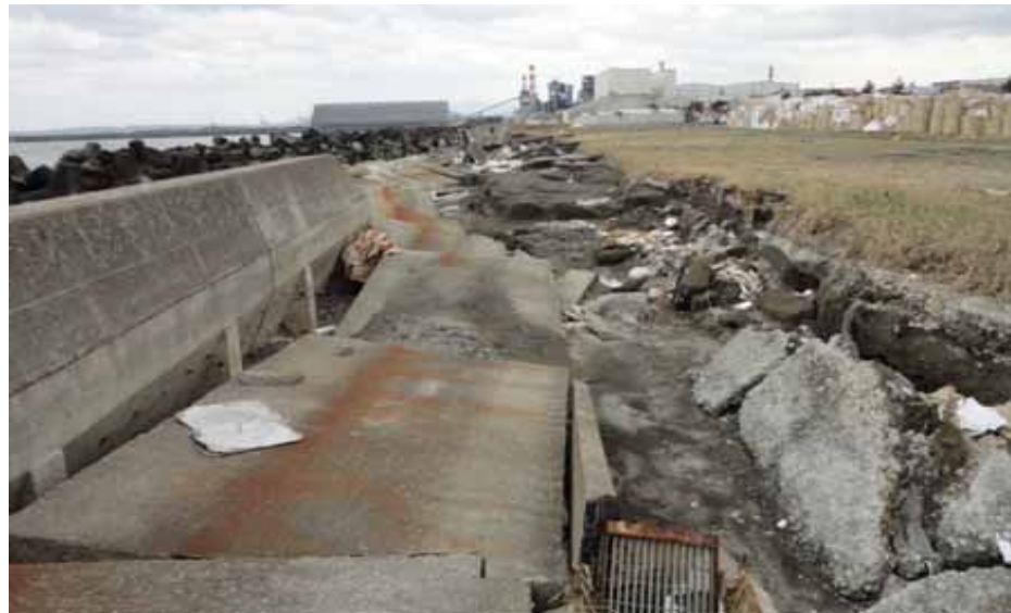
八戸港 八太郎地区 護岸の倒壊
