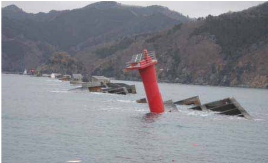
釜石港 湾口防波堤(北堤(延長990m))ほぼ全壊
