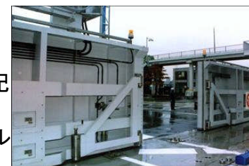
自動化・電動化されている陸閘の例
