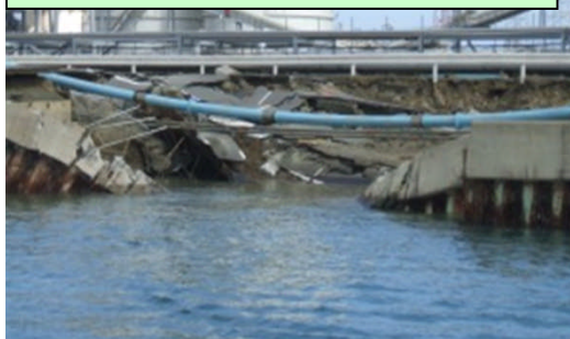
液状化による護岸の被災
