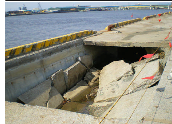
内部土砂流出によるエプロン陥没状況
