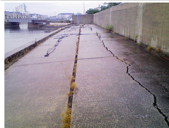
エプロン部の沈下コンクリートの割れ
