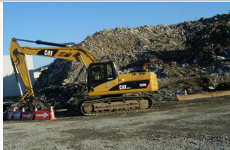
東日本大震災 約半年後の仮置場の例
