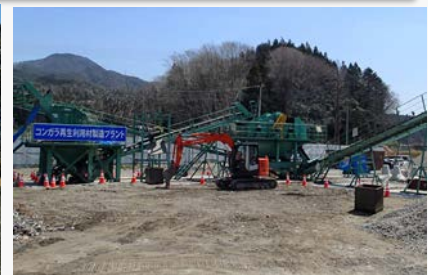
東日本大震災 約2年後 コンクリートがらの再生処理の例
