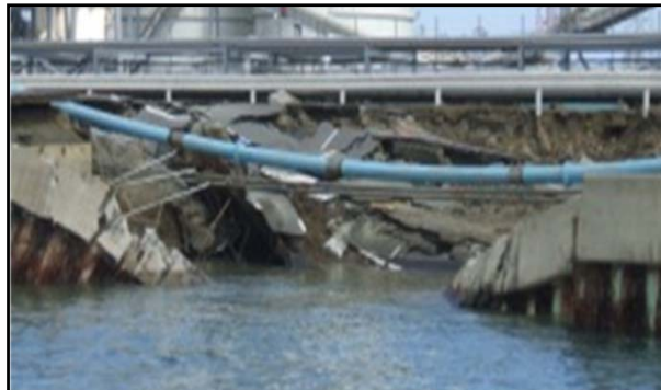
東日本大震災における港湾施設の被災
