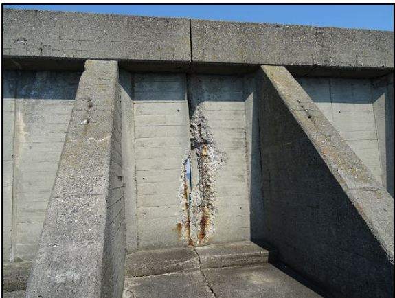
整備前 （既設老朽化状況）
